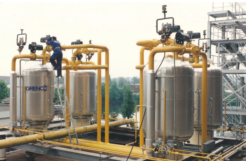
Oliewaskolommen, geïnstalleerd bij de brouwerij van Heineken.
