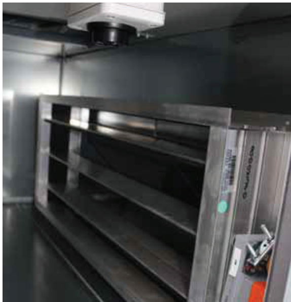
Schone warmtewisselaar en lekbak.
