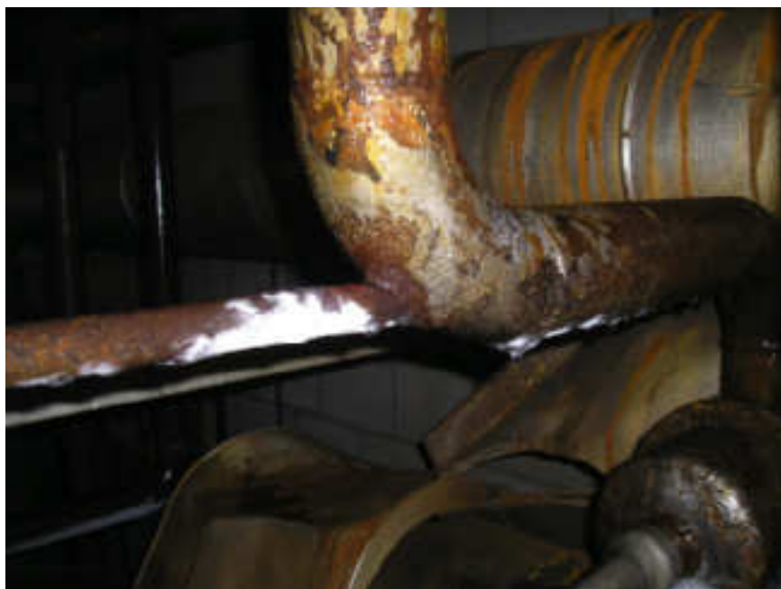
Te controleren leidingwerk van het koudemiddelpompsysteem.
