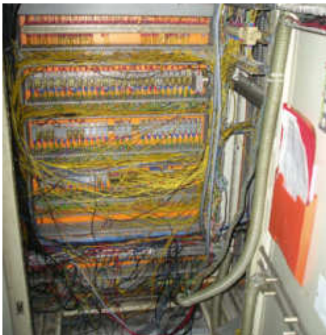
Slecht gemonteerde inwendige (spaghetti) bekabeling in schakelkast.
