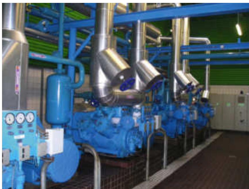
Goed onderhouden machinekamer/installatie ijsbaan Eindhoven.
