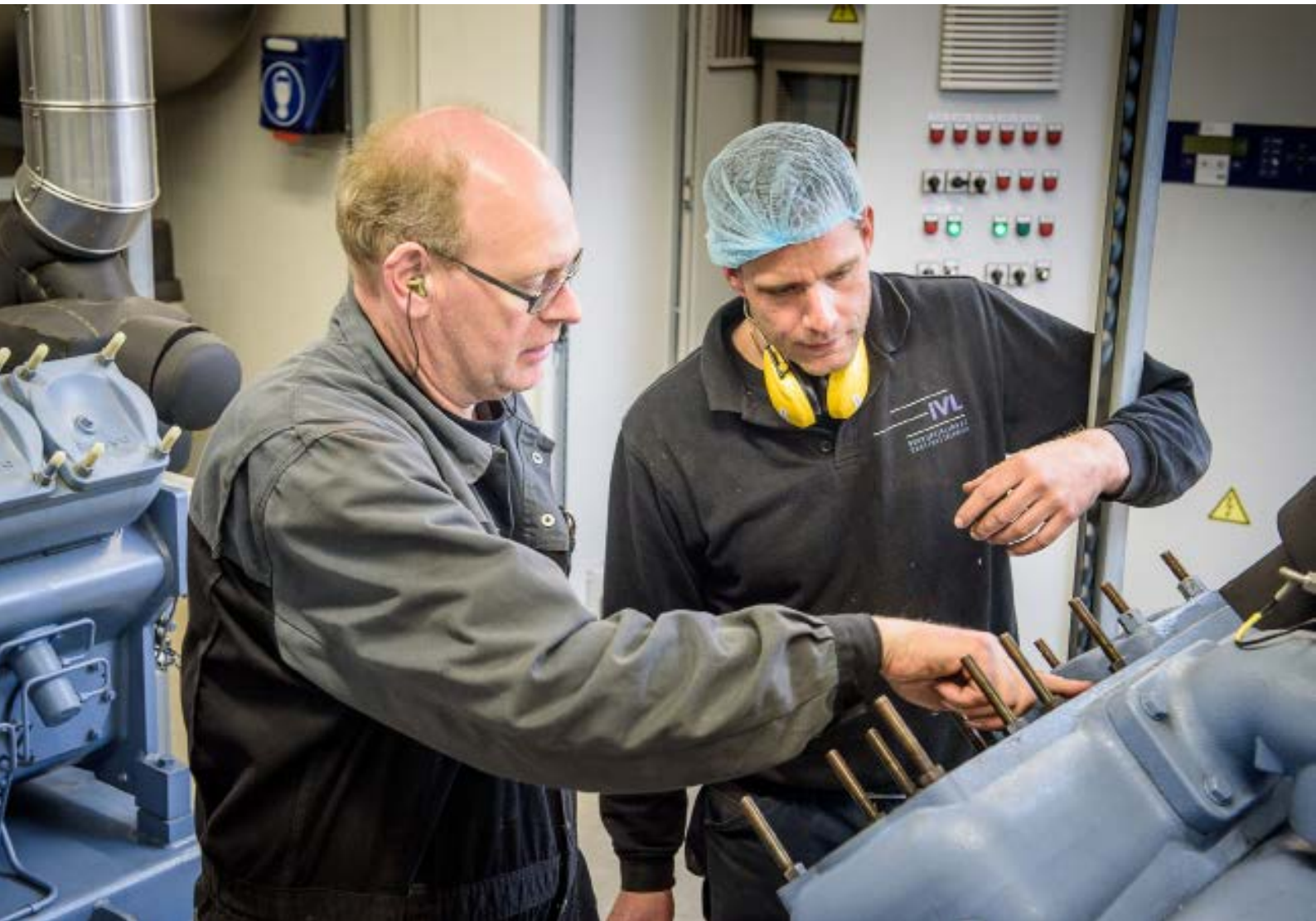
Inspectie van een GEA Grasso V450-compressor op locatie, bij de NH 3 -installatie van IVL Bedrijfskoeling.
